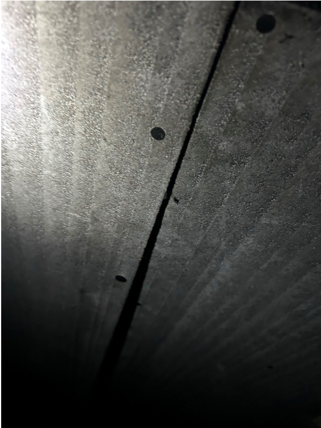
Asbestskivor i tak i pannrum
